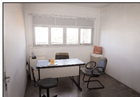
ANTES: Paredes mofadas, móveis velhos
